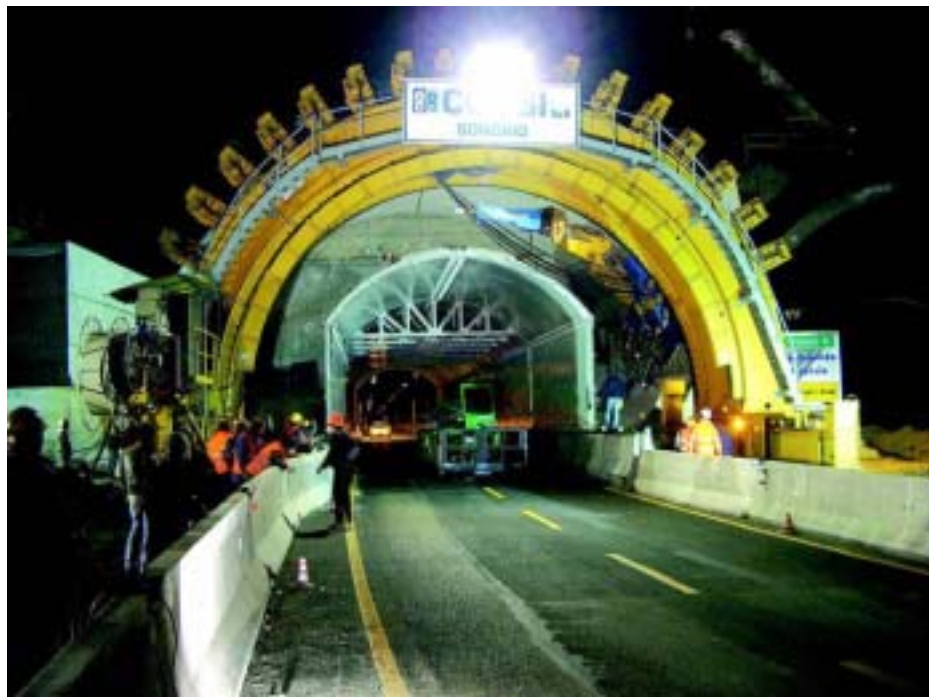
Particolare dei lavori di ampliamento della galleria di Nazzano, sul tratto Orte-Fiano dell'autostrada A1, attualmente in corso ed eseguiti sotto traffico
