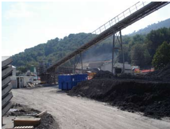
Particolare del nastro trasportatore che collega direttamente il fronte di scavo all'area di deposito dello smarino
