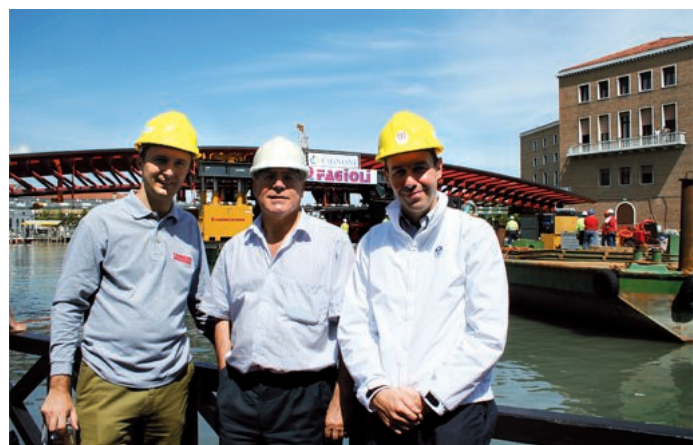
Enzo Siviero, collaudatore del ponte, con i suoi collaboratori Bruno Briseghella (a sinistra), docente all'università di Zagabria, e Tobia Zordan, Corporate Professor al College of Civil Engineering della Tongji University di Shanghai
